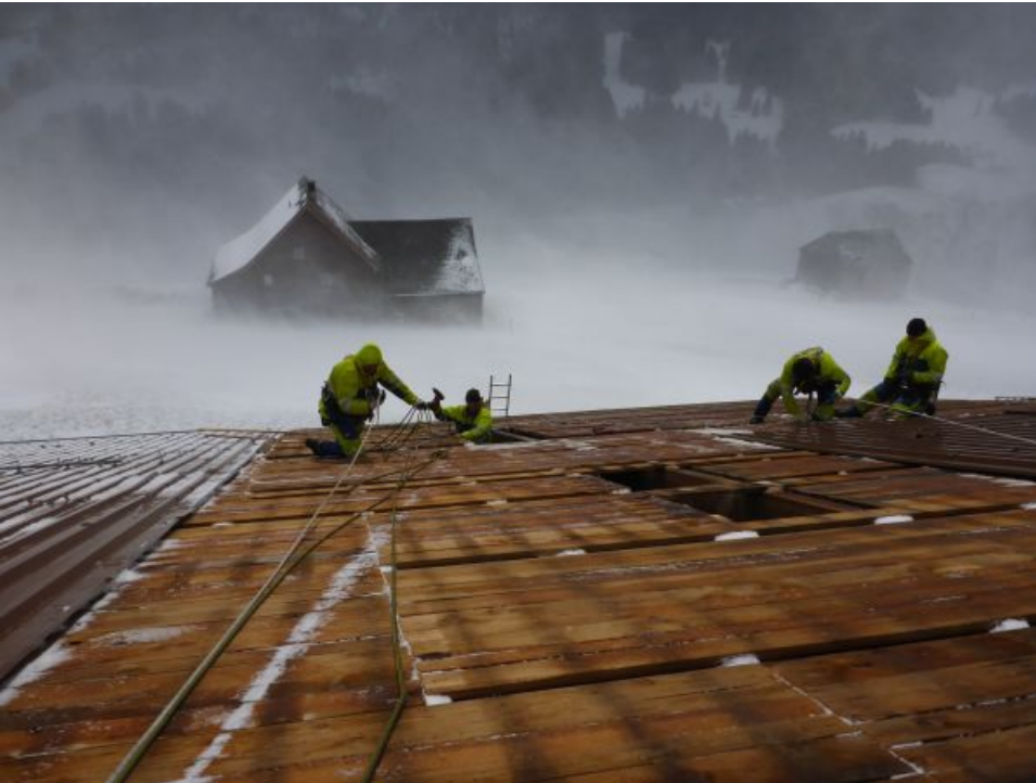
Das Beheben der größten Sturmschäden war für diese Dachdecker nach wie vor nicht einfach (Foto: P. Diener, 01.04.2015).
