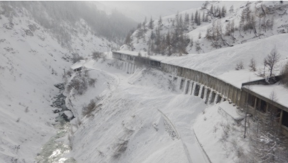
Ablagerung einer grossen Lawine, die bei Sicherungssprengungen zwischen Täsch und Zermatt ausgelöst wurde und die gesperrte Strasse unterhalb der Lawinengalerie verschüttete (Foto: B. Jelk, 06.02.2015).
