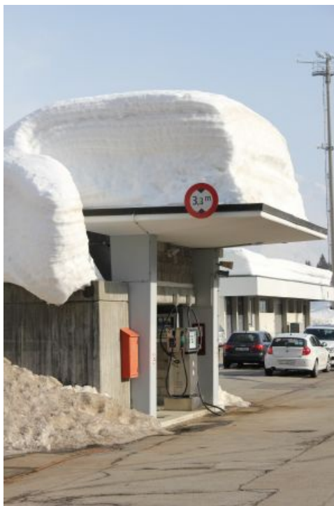
Photo 4 : Grandes quantités de neige sur le toit de la station-service près de l'Office des travaux publics à San Bernardino à 1630 m (photo : SLF/L. Dürr, 10.03.2014).
