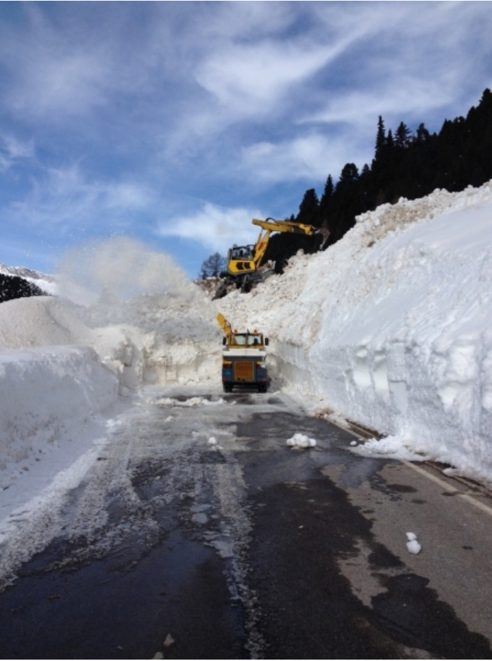
...am Lukmanierpass (TI), welcher aus Sicherheitsgründen zwischenzeitlich wegen Gleitschneelawinen geschlossen werden musste (Foto: F. Genucchi, 23.02.2014), ...
