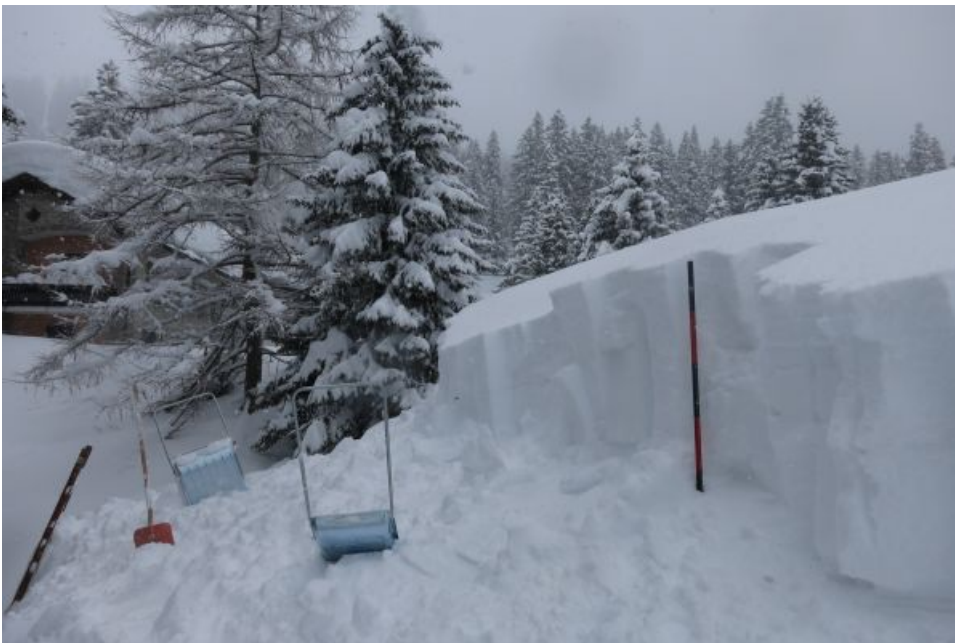
Photo 12: En dégageant la neige du toit, on crée de la place et une réserve de charge pour de nouvelles précipitations. A l'heure actuelle, la charge selon la norme SIA 261 n'est pas encore critique (photo: L. Silvanti 1.02.2014).
