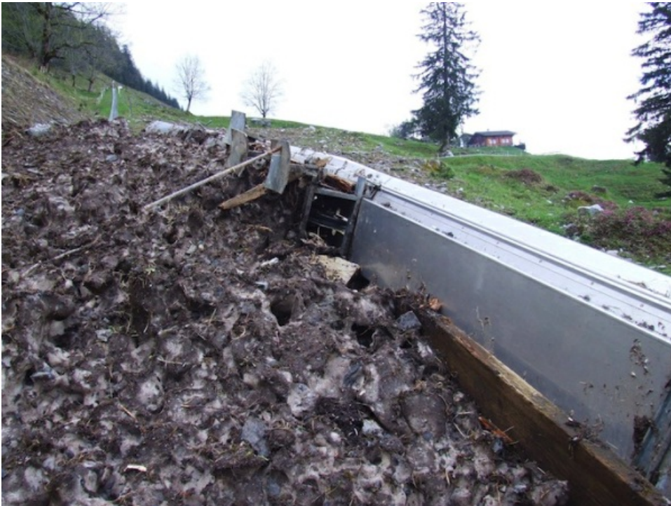
An der Pfingsteggbahn bei Grindelwald (BE) hat eine Nassschneelawine einen Teil der geschlossenen Sommer-Rodelbahn beschädigt (Foto: Jungfrau Zeitung, 01.06.2013).
