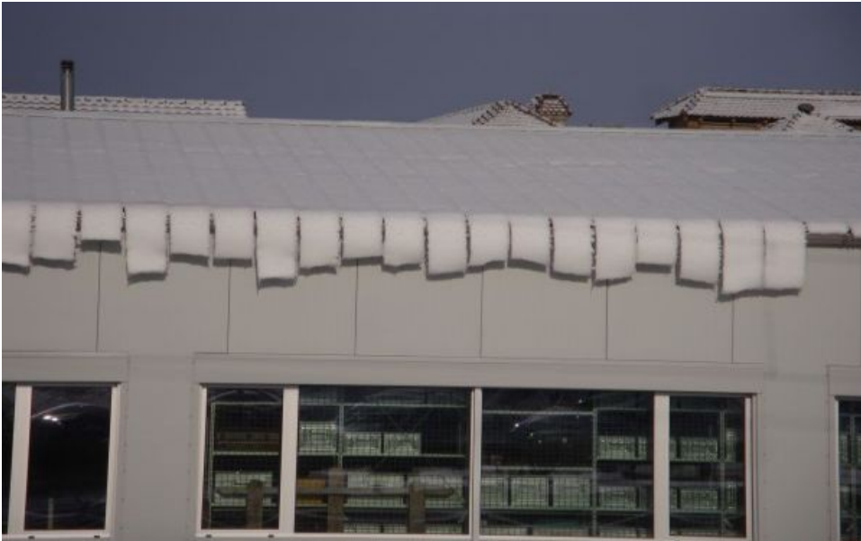
"Schneezauber". Schnee kann sich stark verformen, besonders wenn er warm ist und langsam belastet wird. Das Dach ist nach Süden orientiert, hat eine Neigung von ca. 20 Grad und ist mit Blechbahnen von ca. 50 cm Breite eingedeckt (Foto: H.U. Leuenberger, 09.02.2013).
