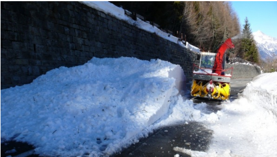
Abb. 6: Räumarbeiten am Col de la Fuorclaz nach einem Nassschneerutsch am frühen Freitag Nachmittag, 24.02.2012 (Photo: J.L. Lugon).
