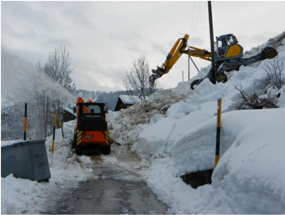
Abbildung 8: Während Tagen kroch bei Untervalzeina/GR (960 m) die gesamte Schneedecke langsam hangabwärts und bedrohte eine Zufahrtsstrasse. Am 24.01. rückte der Mensch mit schwerem Gerät der rund 1 Meter mächtigen Schneedecke zu Leibe. (Foto: M. Balzer, 24.01.2012)
