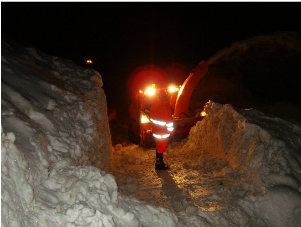
Photo 9: Déblaiement des dépôts d'avalanche sur la route près de Meien (UR). Les travaux ont dû être suspendus temporairement car d'autres quantités de neige menaçaient de glisser sur la route (photo: H.M. Henny, 10.01.2012).
