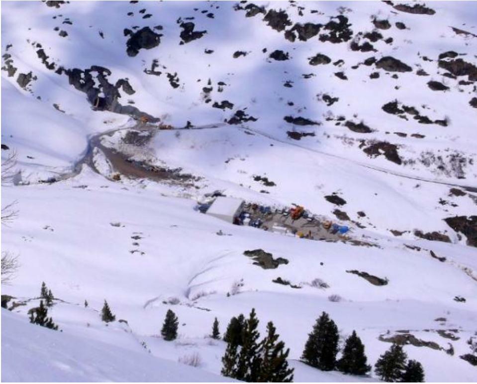
Vue sur la zone du chantier Nant de Drance, Emosson, 1900 m, Trient, VS. C'est le site de construction d'une station de pompage-turbinage (Foto: J.-L. Lugon, 14.04.2010).
