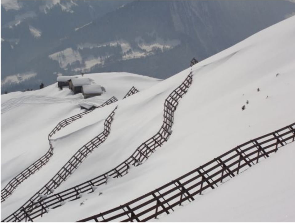
Wenig Schnee und trotzdem bereits teilweise eingeschneite Lawinverbauungen im Gebiet unterhalb Frumaschan im vorderen Prättigau, GR. Das lässt auf ziemlich viel Triebsschnee schliessen (Foto: M. Balzer, 09.03.2010)
