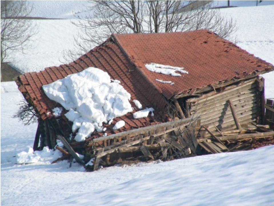
Gebäudeschaden auch ohne Lawine: der Druck des Kriechschnees oder die Schneemenge auf dem Dach waren zu viel für diesen alten Stall in Valzaina, GR (Foto: M. Balzer, 4.4.2009).
