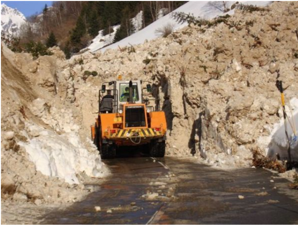
Abb. 7: Die Rohrtallau im Meiental ging in der Nacht vom Dienstag, 17.03. auf den Mittwoch, 18.03. ab und verschüttete die Strasse im Meiental auf 100 m Länge bis zu 4 m hoch (Foto: H.-M. Henny, 18.03.2009).
