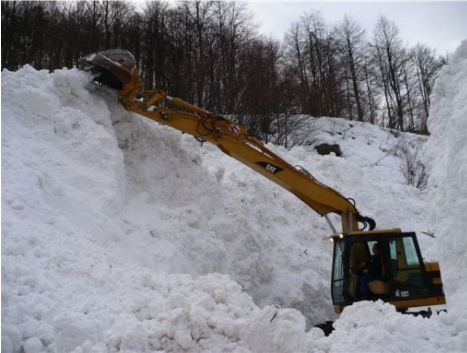
Die Gesealawine verschüttete in der Nacht auf Samstag, 07.02.2009 die Verbindungsstasse zwischen Mesocco und Deira, Misox, GR. Es kamen keine Personen zu Schaden. Die Stasse musste mit grossem maschinellem Aufwand geräumt werden (Foto: S. Fehler, 07.02.2009).
