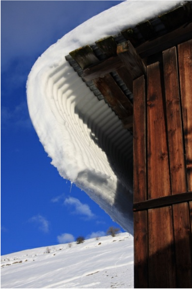
Gleiten des Schnees auf einem Wellblechdach. Beim Knick kam die Gleitbewegung vermutlich eine Zeit lang zum Stillstand und der Schnee bog sich an der Dachkante unter dem Einfluss der Schwerkraft langsam nach unten. Danach setzte die Gleitbewegung wieder ein und der Knick wurde nach aussen geschoben (Foto: SLF/M. Ulmer, 28.12.2008).
