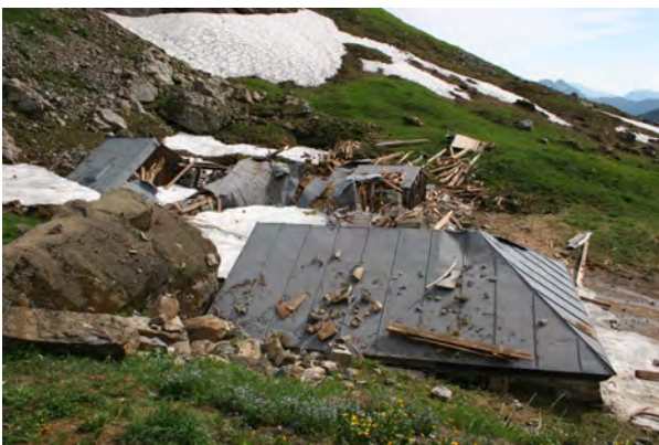
Abbildung 143: Ein Bild der Zerstörung auf der Alp Wis (Lawine Nr. 66)(Foto: S. Lindner, 01.07.2019)
