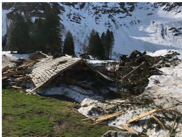
Abbildung 148: Die zerstörten Gebäude auf der Säntisalp wurden im Sommer 2019 wieder aufgebaut (Lawine Nr. 60)(Quelle: Tagblatt.ch).
